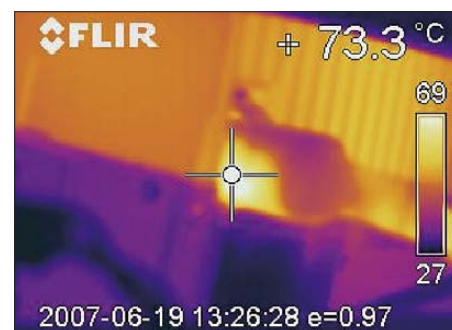
Bild 5: Erhebliche Verluste am vierpoligen Stecker des DC-Kabels der Batteriestromzuführung des Transceivers
